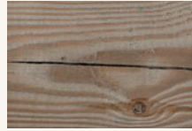
Spanningsscheurtjes door de houtdroging
