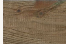
Ruwe plekken op het houtoppervlak
